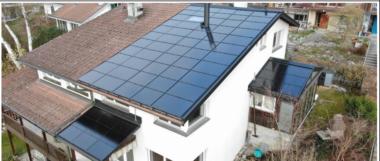
PVA 3S Swiss Solar Solutions – MegaSlate – 15.43kWp – Indach allseitig – Hinterkappelen- 2023
