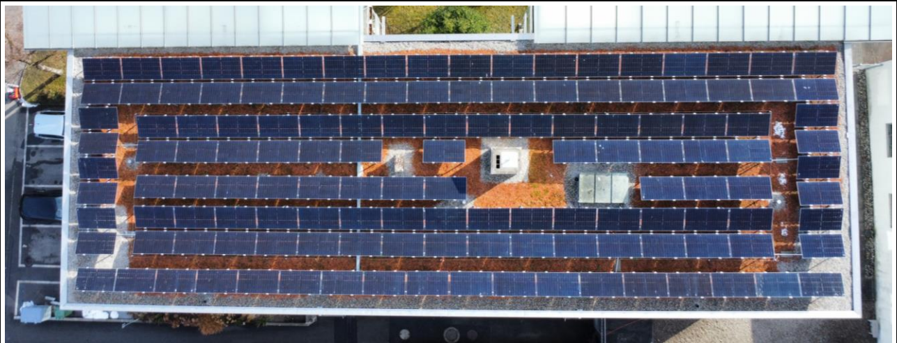
PVA Flachdach – 134 Soluxtec - 46.90kWp - aufgeständert 15° - Sustenstrasse – Thun - 2025
